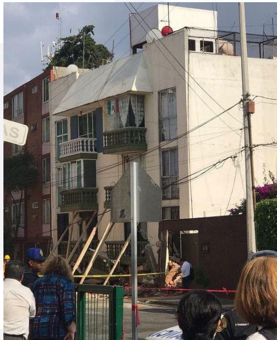
Después del sismo
