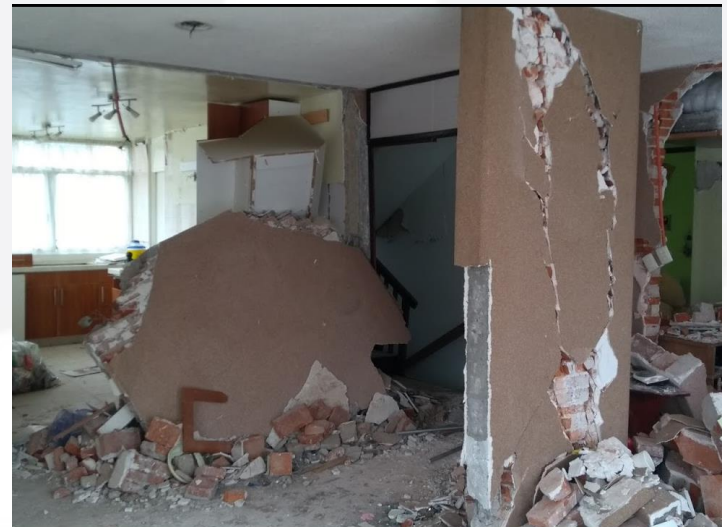
Después del sismo
