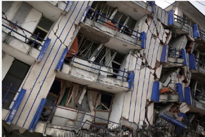
Daños en hotel en Matías Romero, Oaxaca
