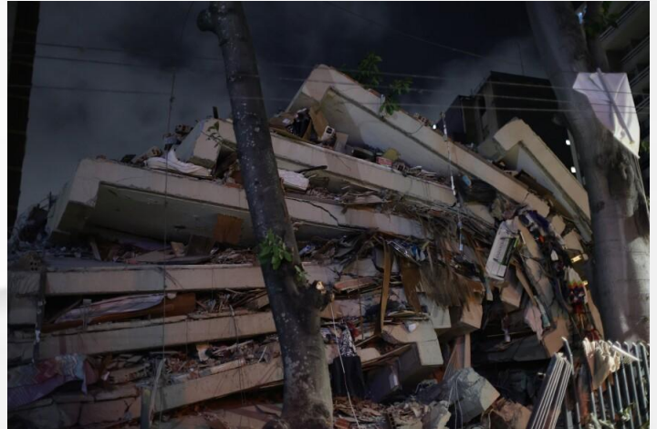
Edificio dañado en Los Palos Grandes, Chacao, Caracas / Damaged building in Los Palos Grandes, Chacao, Caracas Fuente/Source: Jesus Vargas / Getty Images
