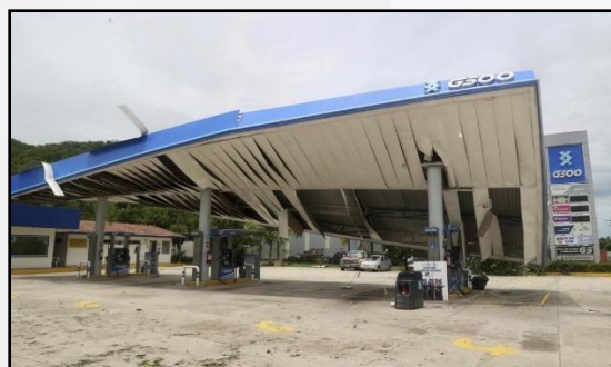
Gasolinera dañada en San José del Progreso, en Oaxaca / A damaged gas station in San José del Progreso, in Oaxaca Foto/Source: Luis Alberto Cruz/AP
