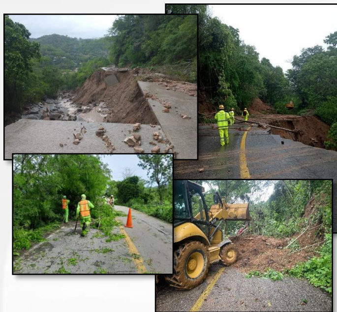
Daño en carreteras en Oaxaca. Servicios de SICT atendiendo derrumbes en carretera / Road damages in Oaxaca. SICT services handling landslides on roads Foto/Source: tw:Centinela_35
