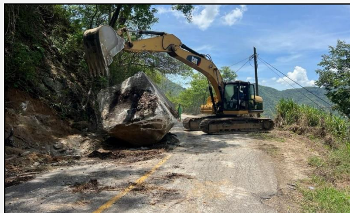
Secretaría de Infraestructura, Comunicaciones y Transportes (SICT) atiende derrumbes en carreteras / Secretariat of Infrastructure, Communications and Transportation (SICT) handles landslides on highways Foto/Source: @SICT_Oaxaca
