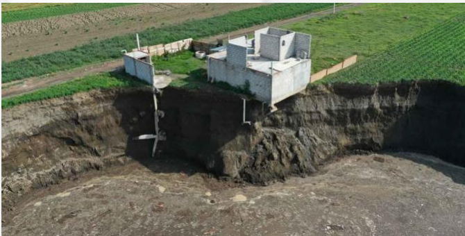
Figura 5. Daños en vivienda de dos niveles de muros de carga de mampostería confinada
