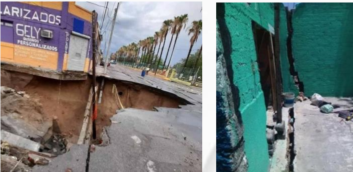
a) b) Figura 4. Daños debido a la presencia de socavones: a) tuberías, carpeta asfáltica y vivienda y b) grietas verticales en muros
