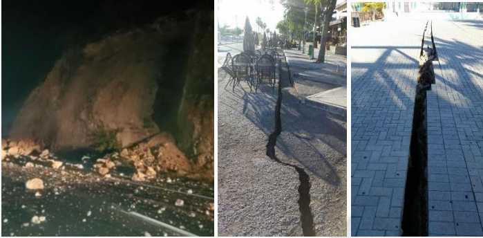
Derrumbes en la carretera y grietas en La Guancha, Ponce. Fuente https://www.telemundopr.com
