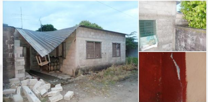
Figura 2. Vivienda en Tuxtepec, Oaxaca afectada por el sismo. Fuente: www.elpinerodelacuena.com.mx
