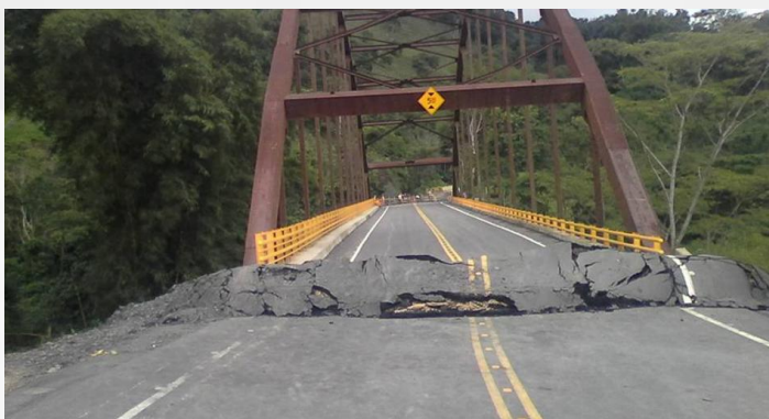
Figura 3. Daños en el puente que comunica Otanche con Puerto Boyacá. Fuente: http://www.eltiempo.com
