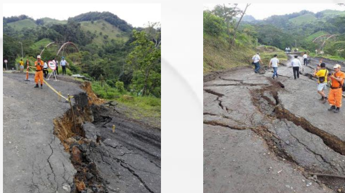
Figura 4. Grietas y desnivel en la banca cercana al puente que comunica a Otanche con Puerto Boyacá.
