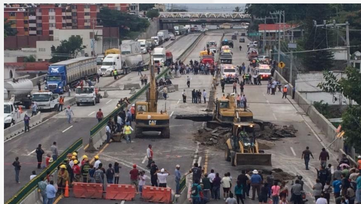
Figura 5. Un vehículo cayó en un socavón que se abrió en los carriles laterales del Paso Expres el 12 de julio del 2017. Fuente: http://media.jornada.com.mx
