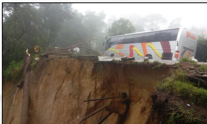
Deslave carretero en Zacapoaxtla, Puebla Foto: vía Twitter / @PC_Estatal
