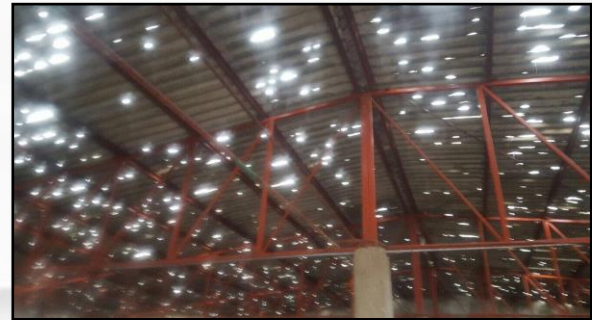
Daños en techos. Fotos: vía Twitter / @ahtzircardenas
