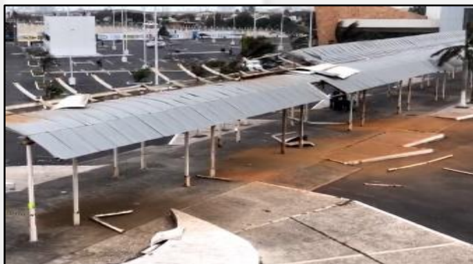
Figura 5. Desprendimiento de láminas en el techo de estacionamientos de la Plaza de las Palmas, Veracruz.
