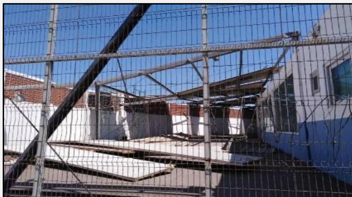
Figura 8. Daños en el techo del edificio de la Cruz Roja.
