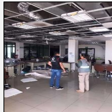
Figura 3. Desprendimiento de plafones en techo del edificio del Poder Judicial del Estado, en la ciudad de Veracruz.
