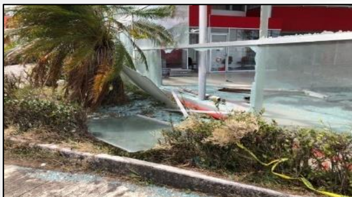
Figura 4. Ruptura de vidrios en fachada del edificio de SEAT, Boca del Río, Veracruz.
