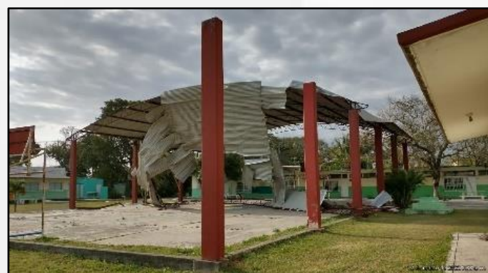
Figura 7. Desprendimiento de la cubierta de lámina en el domo de la Escuela Primaria Miguel Hidalgo.
