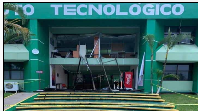
Figura 6. Daños en fachada e interior del Instituto Tecnológico de Misantla.
