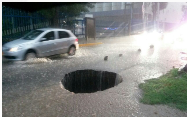
Figura 3. Socavón producido cerca de la UAQ. Fuente: Antonio Arochi.
