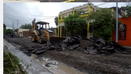
Daños en Monterrey. Fuente: Cuartoscuro
