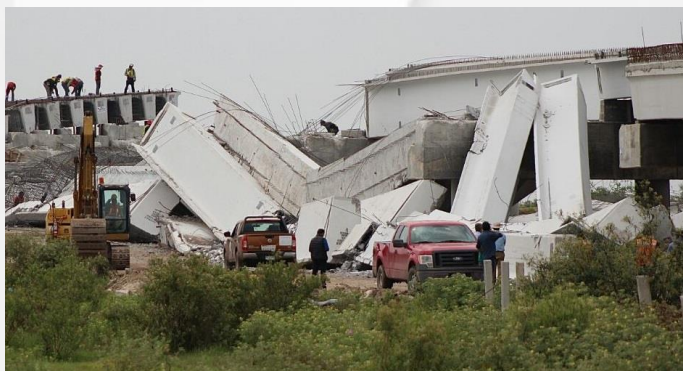
Colapso de una sección de un puente en construcción de la nueva autopista Pirámides- Texcoco Collapse of a part of a bridge under construction of the new highway Piramides- Texcoco
