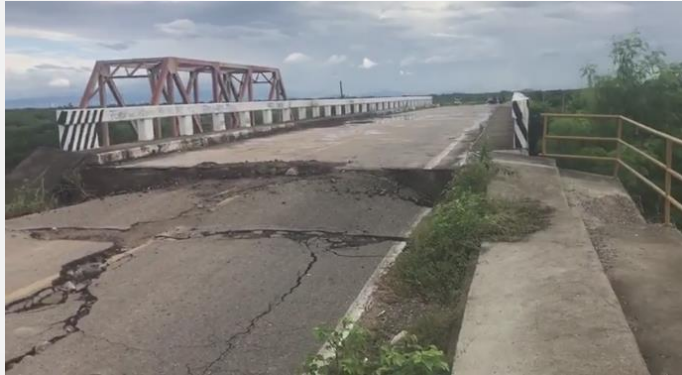
Daños en puente el Estero / Estero bridge damage
