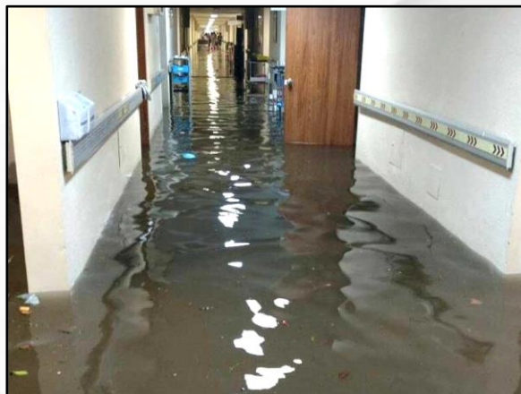
Inundaciones en el Hospital General de La Villa. Foto: vía Twitter / @lberomed
