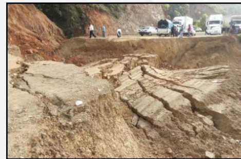
Derrumbe en carretera federal Chilpancingo-Tlapa. Fuente: La voz de Durango
