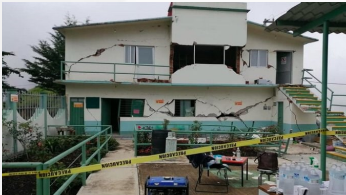
Daños graves en clínica rural del IMSS Fuente: https://oaxaca.quadratin.com.mx/
