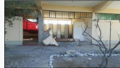
Daños en escuelas en Arequipa / School damage in Arequipa Fuente / Source: https://elcomercio.pe/
